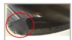
Écaillage dû à un manque de renfort
